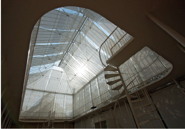
10. Foto do corpo principal da estufa com sistema de tela de sombreamento activo.
