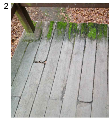
2 Reparación del piso en mal estado en solaina y corredor
